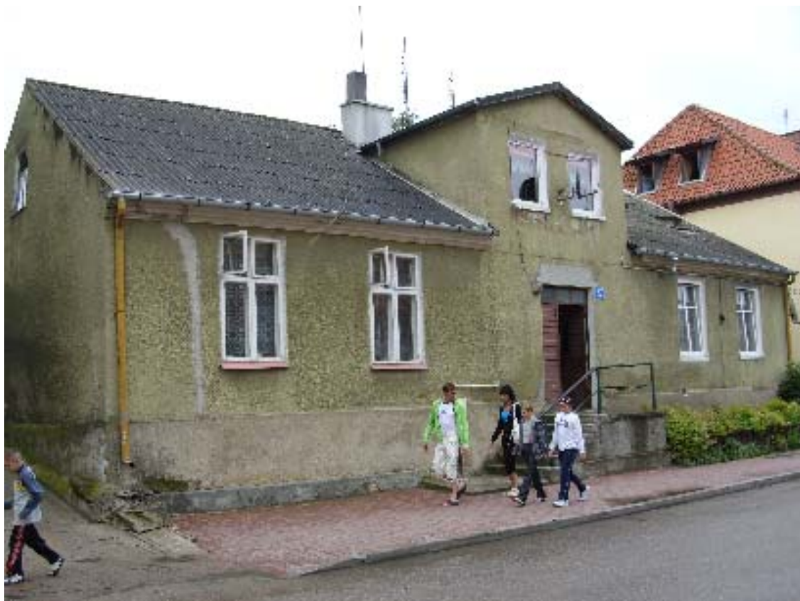
Budynek ul. Kajki 3 – z dachem z płyt azbesto-cementowych
