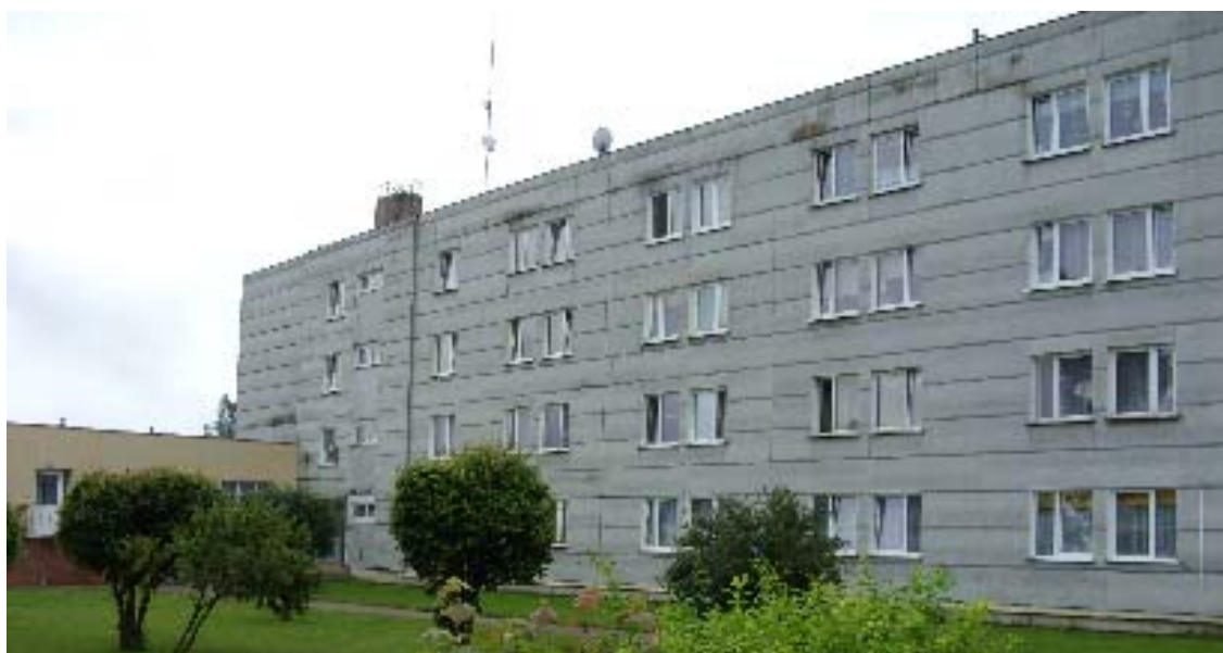
Budynek nauczycielski ul. Łabędzia 1 B – jego fasada w całości wykonana jest z płyt azbesto-cementowych
